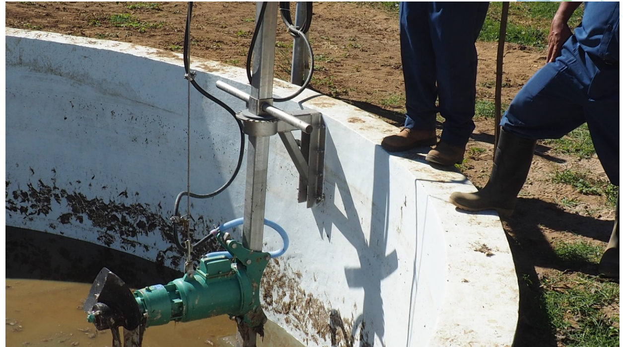
Instalación en tanque de alimentación
