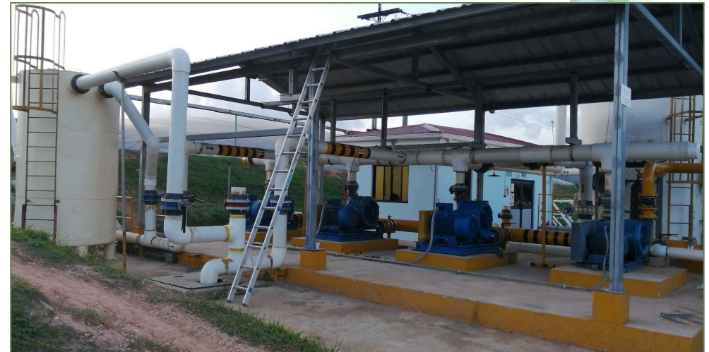
Sopladores de 60 kW en biodigestor en extractora de aceite de palma africana
