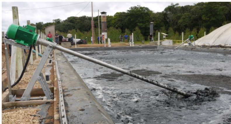
Instalación en tanque estercolero o laguna
